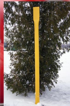
Опознавательный столбик для систем газоснабжения
